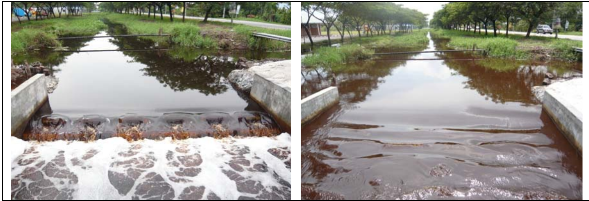
CHECK DAM BERFUNGSI DENGAN BAIK
